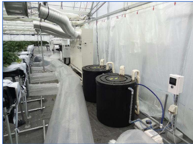
新開発の地下水熱源ヒートポンプ
