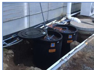
地下水熱源ヒートポンプ
