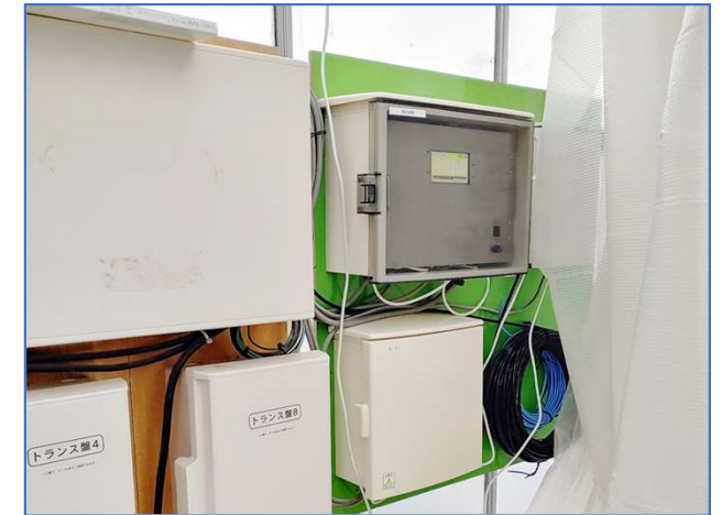
ZEG仕様の複合環境制御装置
