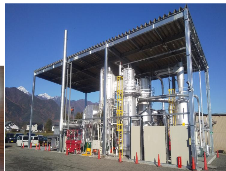
バイオマス燃料製造設備
