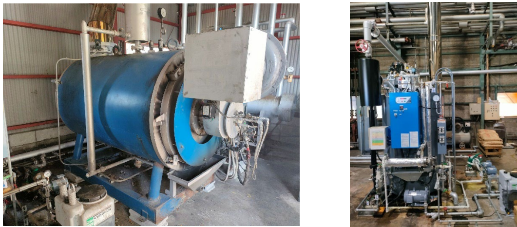
図 50. 油脂精製時の熱源となる廃油ボイラー
