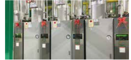
貫流ボイラー (インドネシア) DIC
