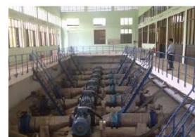
高効率ポンプ (ベトナム)
