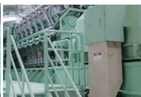
ガスコージェネレーション
