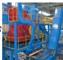
金属破碎・選別設備
