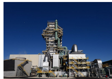
バイオマス発電施設
