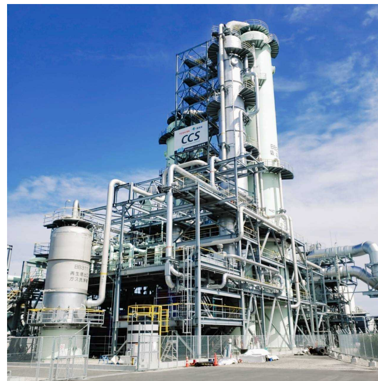
CO 2 回収実証プラント
