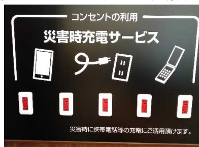
災害時に提供する充電設備
