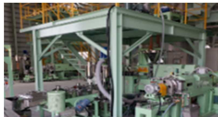
バイオマスプラスチック製造設備
