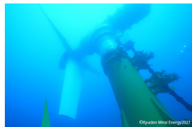
潮流発電設備
