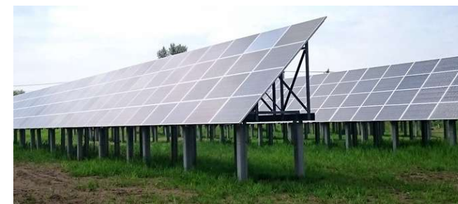
▲太陽光発電パネル(石狩データセンター併設)
