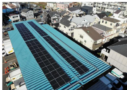
ヤマト運輸【太陽光発電設備】
