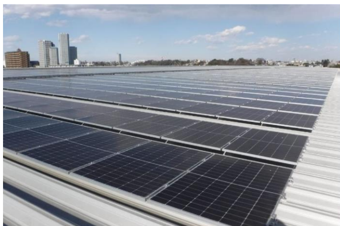
アマゾンジャパン【太陽光発電設備】
