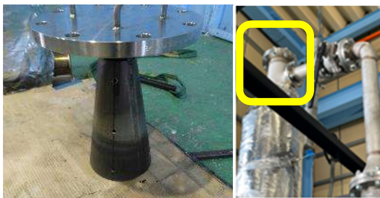
図 4.2 テレフタル酸除去専用パーツ、及び反応塔上部の取付箇所
