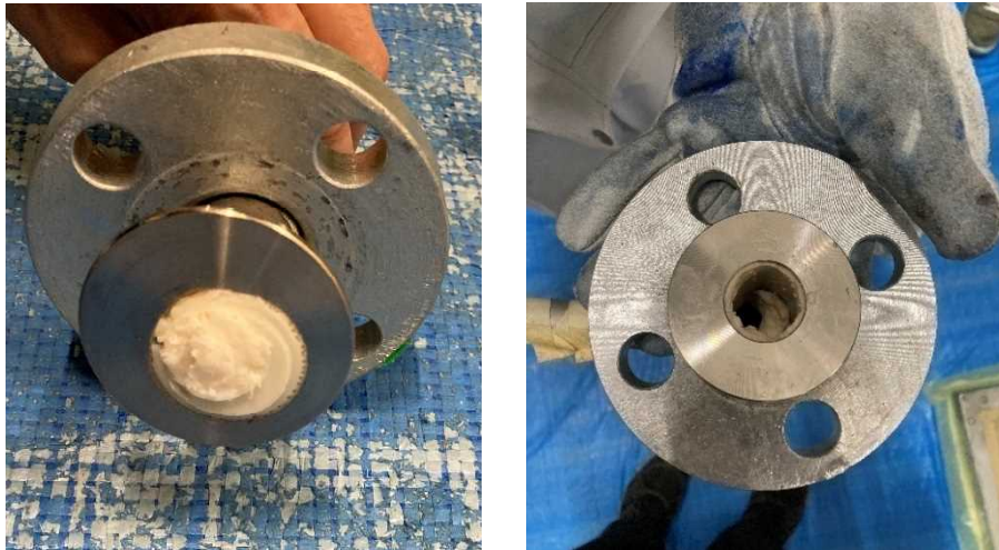
図．25 配管閉塞の様子
