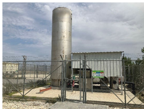
メタンガスの回収装置
