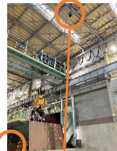
上：燃えないごみピットの熱検知カメラ 下：放水銃（遠隔手動操作）
