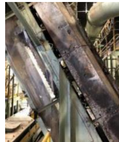
火災で焦げた破碎物コンベヤ
