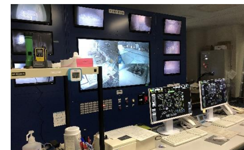
各種センサーの監視装置
