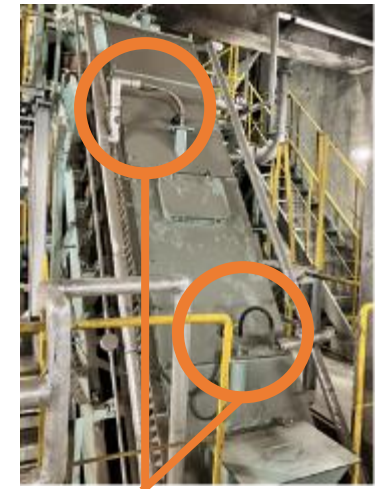
発煙・発火が多い破碎物搬送コンベヤ上に自動散水装置を増設
