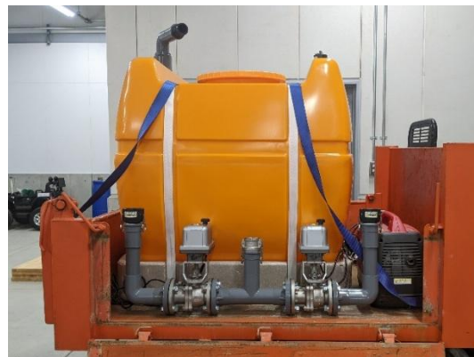
配管及び電動ボールバルブ
