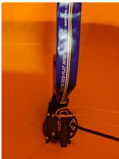
汚水ポンプ(電動)
