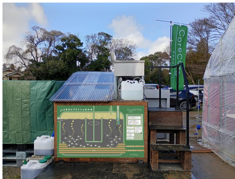
図 18 設置したオープンバイオガスプラント 発酵槽説明看板はイメージ(3月末に掲示予定)
