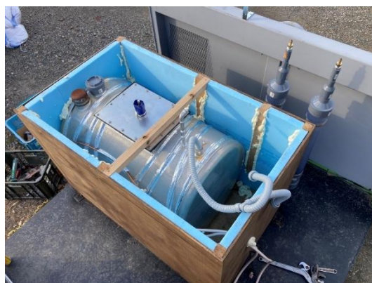
銅管でお湯を回す加温と断熱
