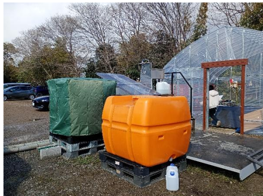
プラントに併設した温室や液肥タンク
