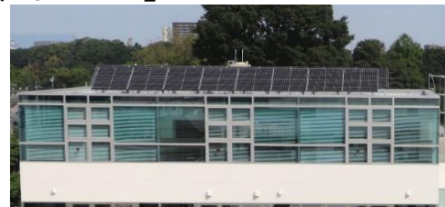
再生可能エネルギー（太陽光）設備
