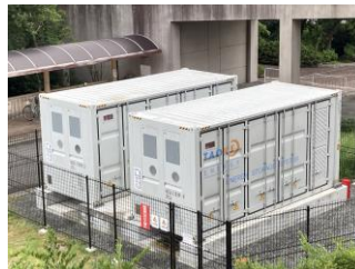
設置された大型蓄電池（写真：JFEE提供）
