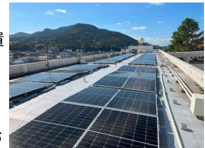
大野小学校における設置状況（写真：NSP提供）
