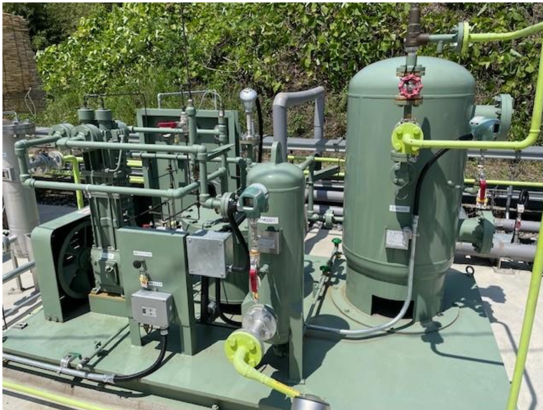
【圧縮機写真】 (正面)
