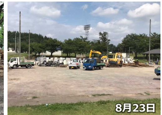
戸沢村の仮置場の状況
