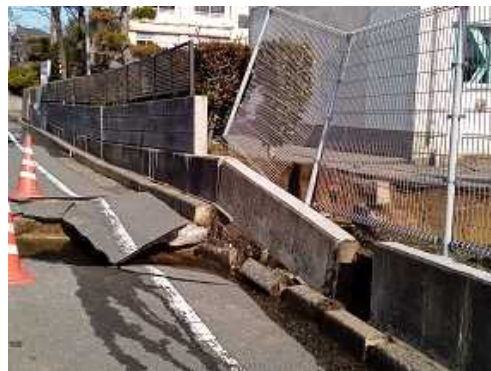
新潟県新潟市 路面の隆起 （1 月 2 日）
