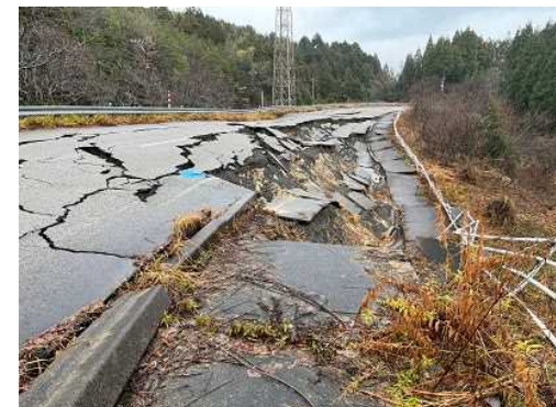
石川県七尾市 道路被害 （1 月 9 日）
