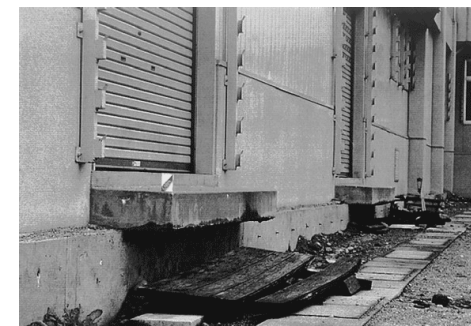
地盤沈下による被害（南魚沼市）
