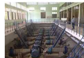
高効率ポンプ （ベトナム）
