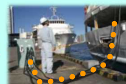
電力供給設備
