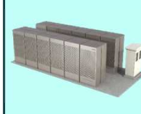
自立型電源 (蓄電池設備含む)
