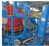
金属破碎・選別設備
