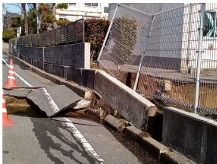
新潟県新潟市 路面の隆起 （1月2日）
