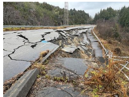
石川県七尾市 道路被害 （1月9日）
