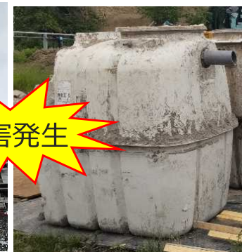
被災した浄化槽
