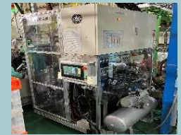
①プラスチックリユース設備
