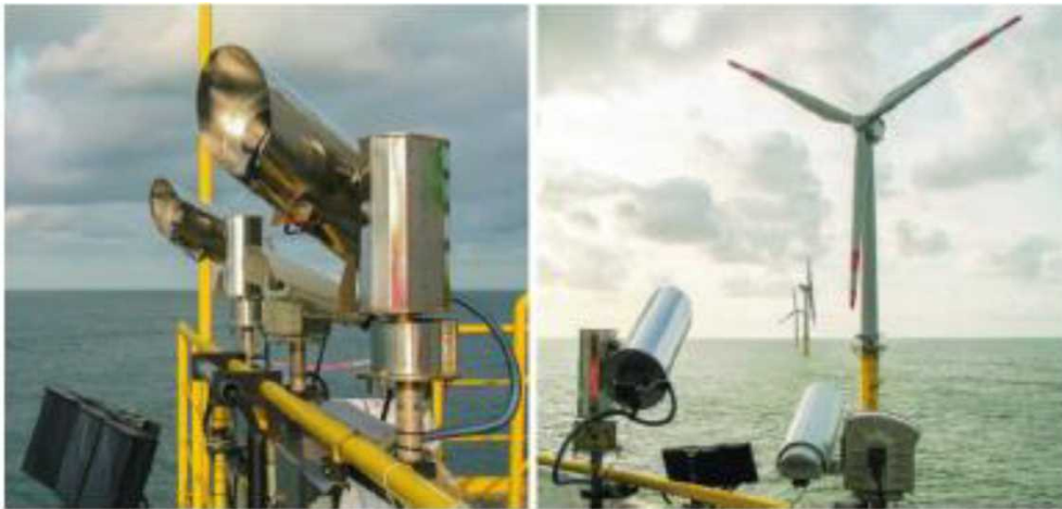
Alpha Ventus洋上風力発電の外側にある変電施設に設置された可視カメラ及び赤外線カメラ。カメラはローター回転域を監視できる位置に設置される。
