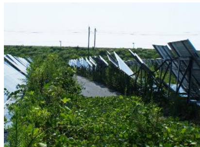
不十分な管理で放置されたパネル
