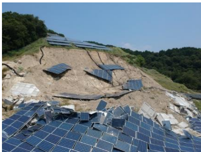
土砂崩れで生じた崩落
