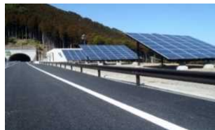
道路における太陽光発電の活用
