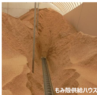
もみ殻バイオマスボイラ
