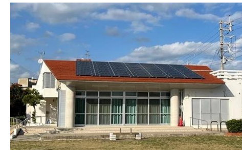
公共施設への太陽光パネルと蓄電池の設置
