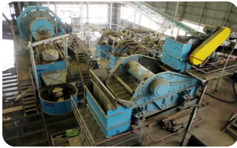
浄化等処理施設（浄化）
