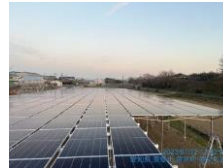
オフサイトPPAは合計2MW
