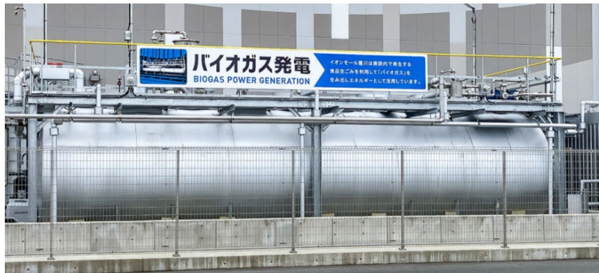
バイオガス発生装置
