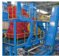
金属破碎・選別設備
