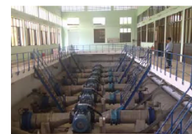
高効率ポンプ （ベトナム）
