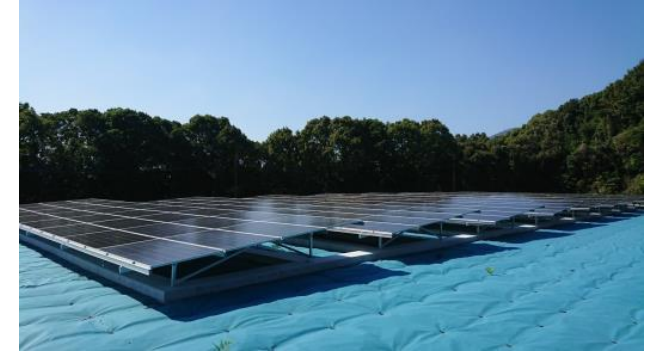
配水池に導入した太陽光発電
