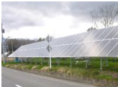
柵塀の設置されない設備
