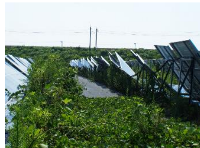
不十分な管理で放置されたパネル
