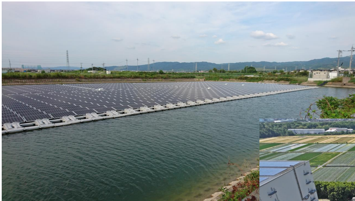
水上への設置 奈良県
