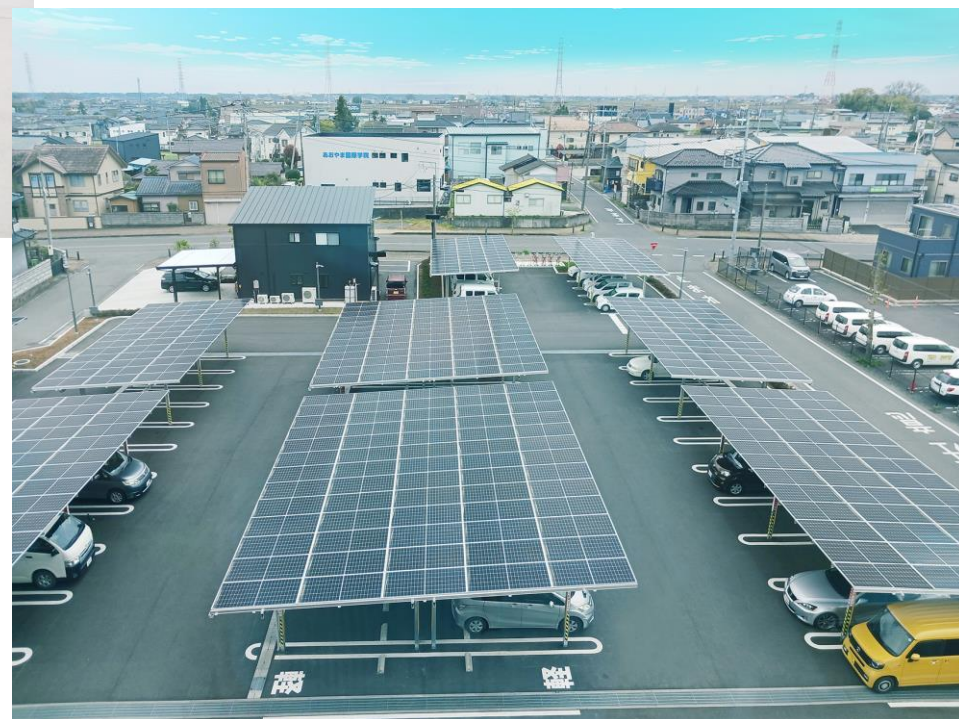
ソーラーカーポート 下妻市役所様 駐車場
