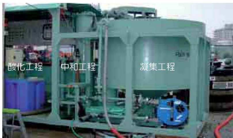
図 8-13 酸化、中和、凝集装置の概況写真
