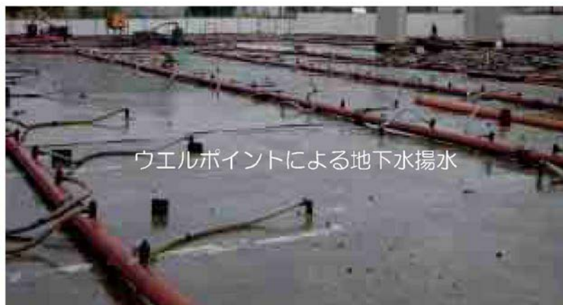
図 8-12 地下水揚水の概況写真
