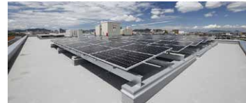
屋上の太陽光発電設備
