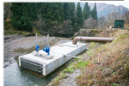
小水力発電施設
