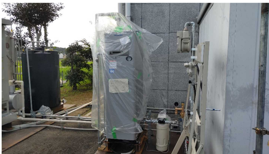
図 4-2-7 ボイラ設置状況
