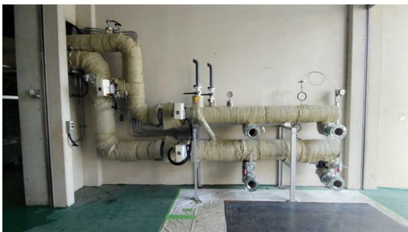
図 4-1-7 蓄熱装置（反応器）通気ダクト設置状況
