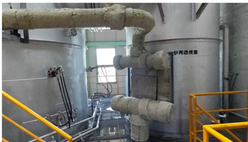
図 4-1-5 ごみ焼却炉再燃焼室への高温空気加熱器の設置状況
