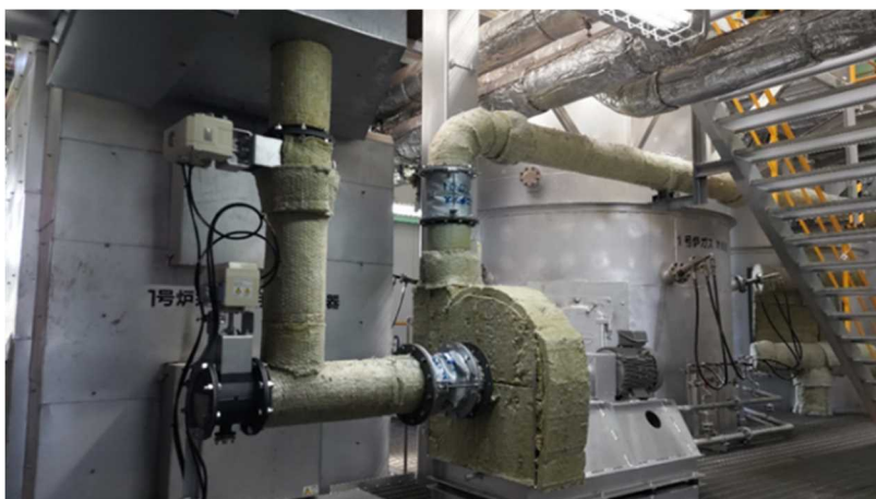
図 4-1-6 送風機設置状況
