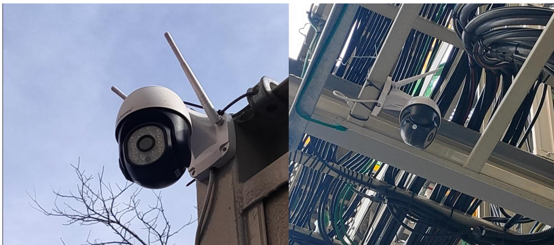
図 5-5-4 Wi-fi カメラの設置状況
