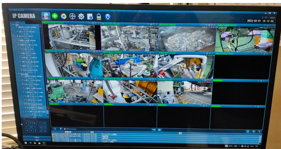
図 5-5-5 中央制御室での監視状況
