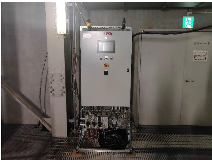
図 3-18 圧力波式スートブロワ設置状況（制御盤）
