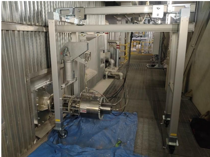
図 3-17 圧力波式スートブロワ設置状況（スートブロワ本体）
