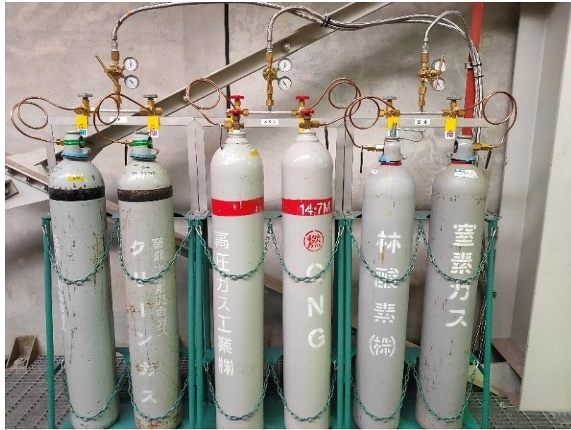
図 3-19 圧力波式ストブロウ設置状況（駆動用ガス）
