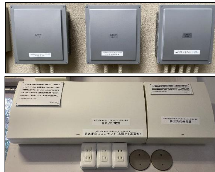
千葉市立千城台西中学校 設置設備 上段) パワーコンディショナ 下段) 非常用コンセント盤
