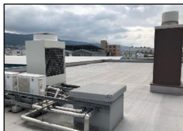
東大阪市東事業所 パネル設置箇所
