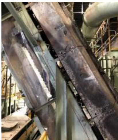
図 5-2 火災で焦げた破砕物コンベヤ
