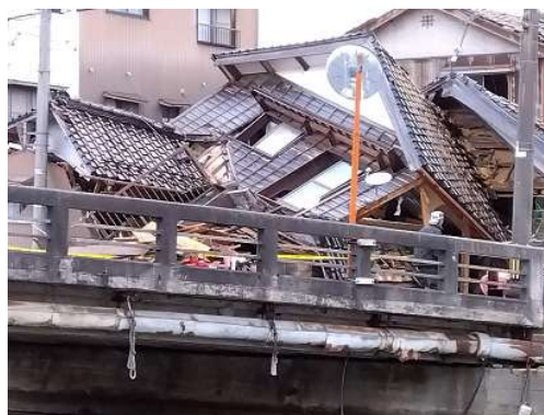
石川県穴水町 民家の被害 （1月5日）
