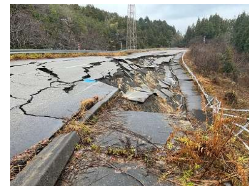
石川県七尾市 道路被害 （1月9日）
