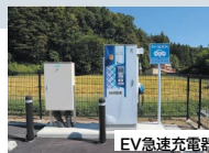
EV急速充電器
