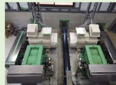
水車発電機2基
